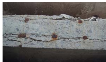
図-1 RC床版内に生じた水平ひび割れ
